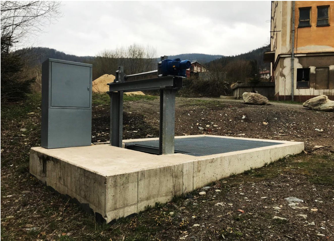
Obr. 41- Mechanismus k regulaci průtoku MVE Vilémov – regulační uzávěr
