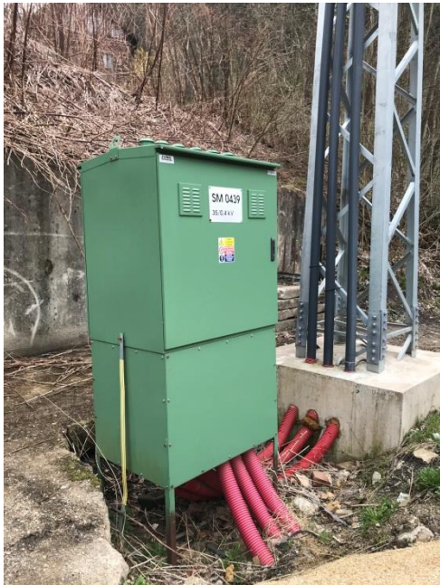
Obr. 33- Transformační stanice 35/0,4 kV
